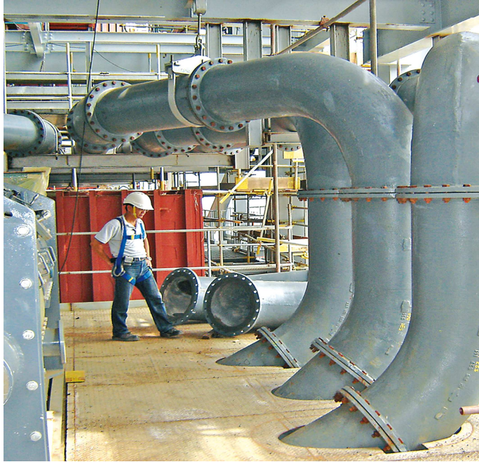
Les tuyauteries représentent une application typique de l'utilisation de la fonte alliée anti-usure KALMETALL-C ; ici une conduite de charbon pulvérisé dans une centrale thermique en Asie du sud-est
