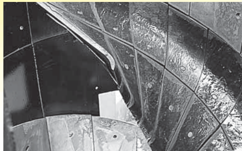
Schachtwendel im Steinkohlebergbau mit bewährter KALMETALL-C Auskleidung
