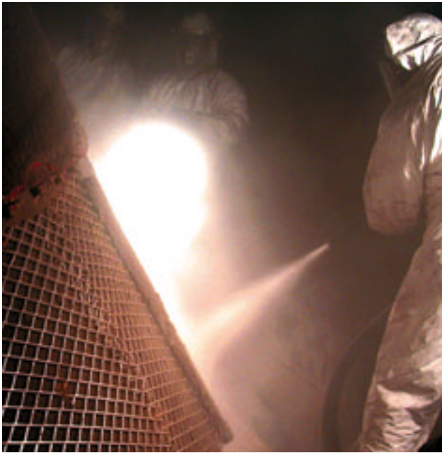
Abb. 6: Mit der Kalenborner Spritztechnologie für das Hartstoffkompound KALCRET-S wird sicherer Verschleißschutz bei kurzen Montagezeiten realisiert
