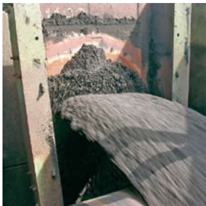
KERAFLEX-KRM contre les sollicitations d'abrasion et de chocs dans une goulotte de déversement de char- bon et de minerai de fer dans une installation de transbordement portuaire
