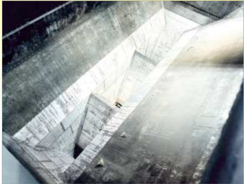
Revêtement mixte améliorant le glissement dans la partie inférieure d'une trémie: avec revêtements KALEN sur les faces inclinées et KALINOX aux sorties plus sollicitées.
