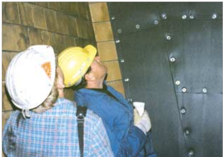
Revêtement mixte dans une grande trémie à fines de charbon. Les faces soumises à des sollicitations différentes sont protégées en conséquence, ici par exemple en KALCERAM et KALEN.
