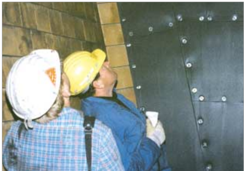
Auskleidungskombination in einem Feinkohle-Großbunker. Die unterschiedlich beanspruchten Flächen sind den Beanspruchungen entsprechend geschützt, hier z.B. mit KALCERAM und KALEN.
